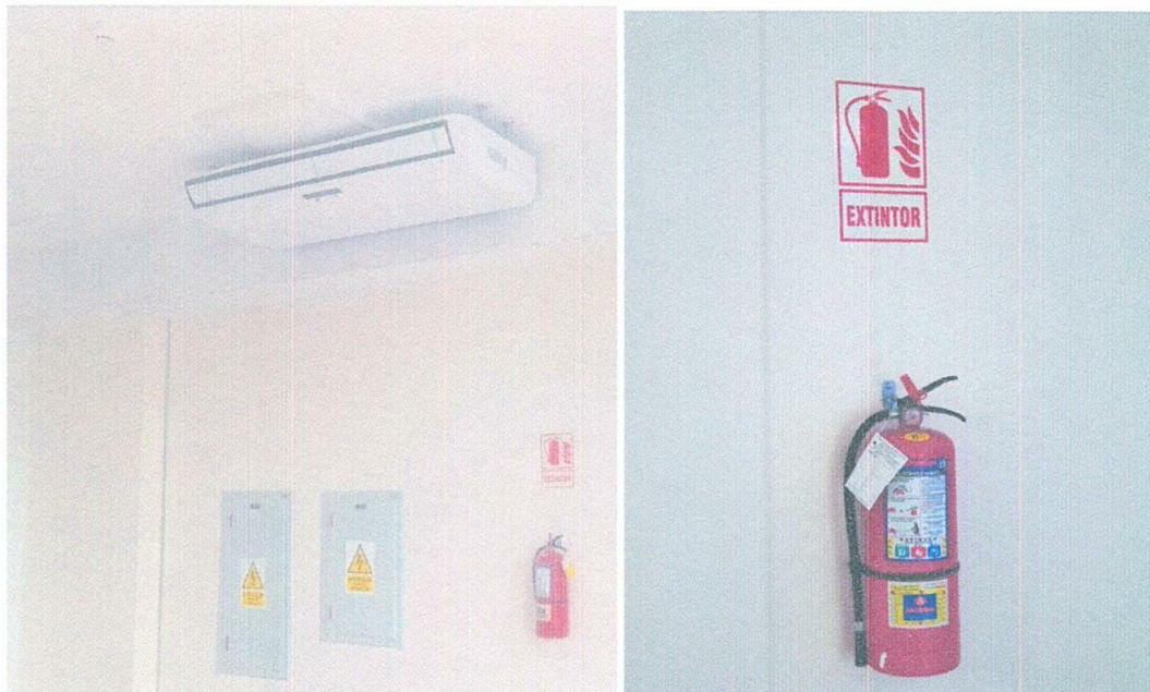
Fotografía 01: Equipo de aire acondicionado y Extintor del Centro de Cómputo.
