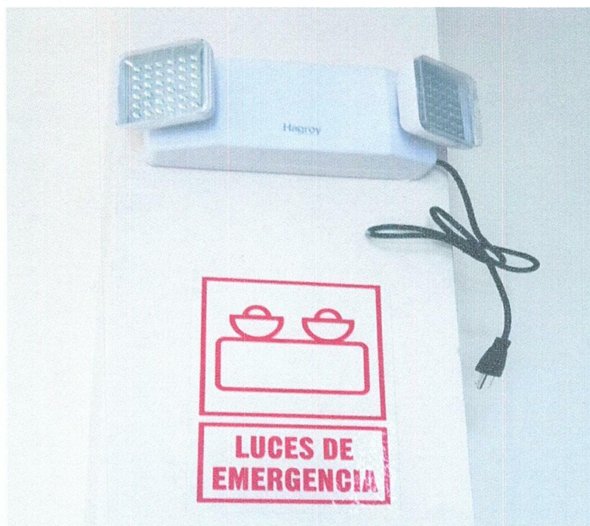
Fotografía 07: Luces de emergencia Centro de Cómputo.
